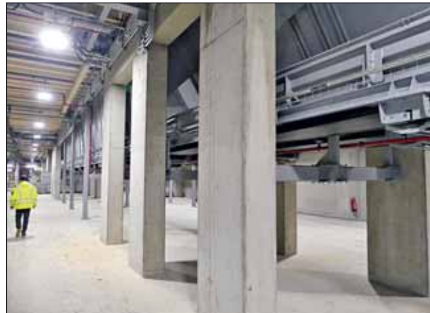
Entsorgungskeller unter der Spanerlinie
