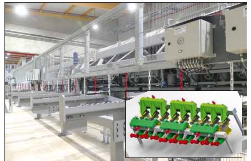
Der hier erstmals installierte Linck-Seitenbrettseparator „SEL“, der ganz ohne Förderketten arbeitet und stattdessen Transportrollen mit Riemenantrieb nutzt.
